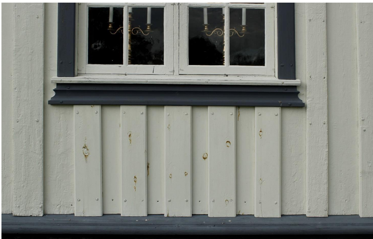
Figur 3. Oppdal kirke. Detalj av sokkellista og nedre del av panelet på sakristiet mot øst. Typiske gjennomslagsskader av kvister i det nye panelet. Foto: J. Brønne. 22.8.2023.
