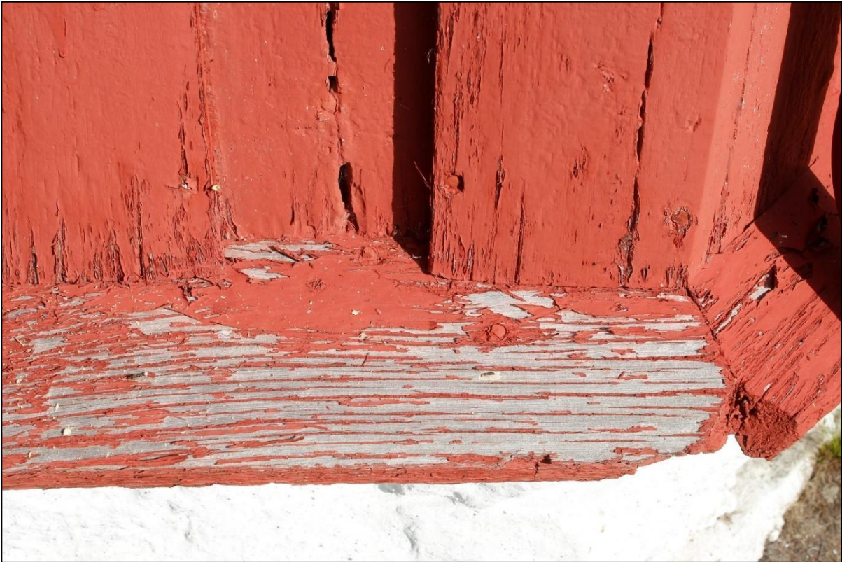
Figur 2. Lønset kirke. Detalj av sokkellista og nedre del av panelet. Bildet viser typiske skader i treverket i nedre del av panelet og malingskader på panel og vassbord. Så små sprekker som på panelbordet til høyre krever ingen tiltak, men sprekker som på det midtre panelbordet bør bøtes inn. De dyktige snekkerne som tidligere har utført arbeider på Lønset -, og Oppdalkirkene vurderer hvor det er nødvendig med tiltak. Foto: J. Brønne. 22.8.2023.
