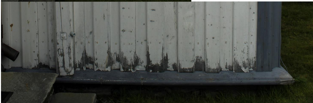
Figur 5. Oppdal kirke. Detalj av figur 4, som tydeligere viser skadene. Foto: J. Brænne. 22.8.2023.
