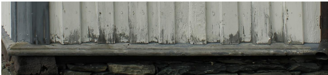
Figur 2. Oppdal kirke. Detalj figur 1. Malingen på vassbordet er helt avslitt. Det er fuktskader med opp-, og avskallinger i nedre del av panelbordene. Det er også noen angrep av svertesopp. Noen av panelbordene har også gjennomslag av kvister. Foto: J. Brønne. 22.8.2023.
