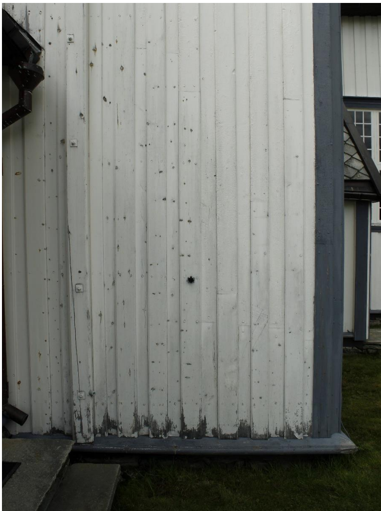
Figur 4. Oppdal kirke. Detalj av nordøstveggen i skipet. Her finner vi alle skadetyperne som er beskrevet over. Bortsett fra gjennomslagene av kvister, kan alle de øvrige skadene relateres til snø og høy fuktighet gjennom deler av året. Foto: J. Brænne. 22.8.2023.
