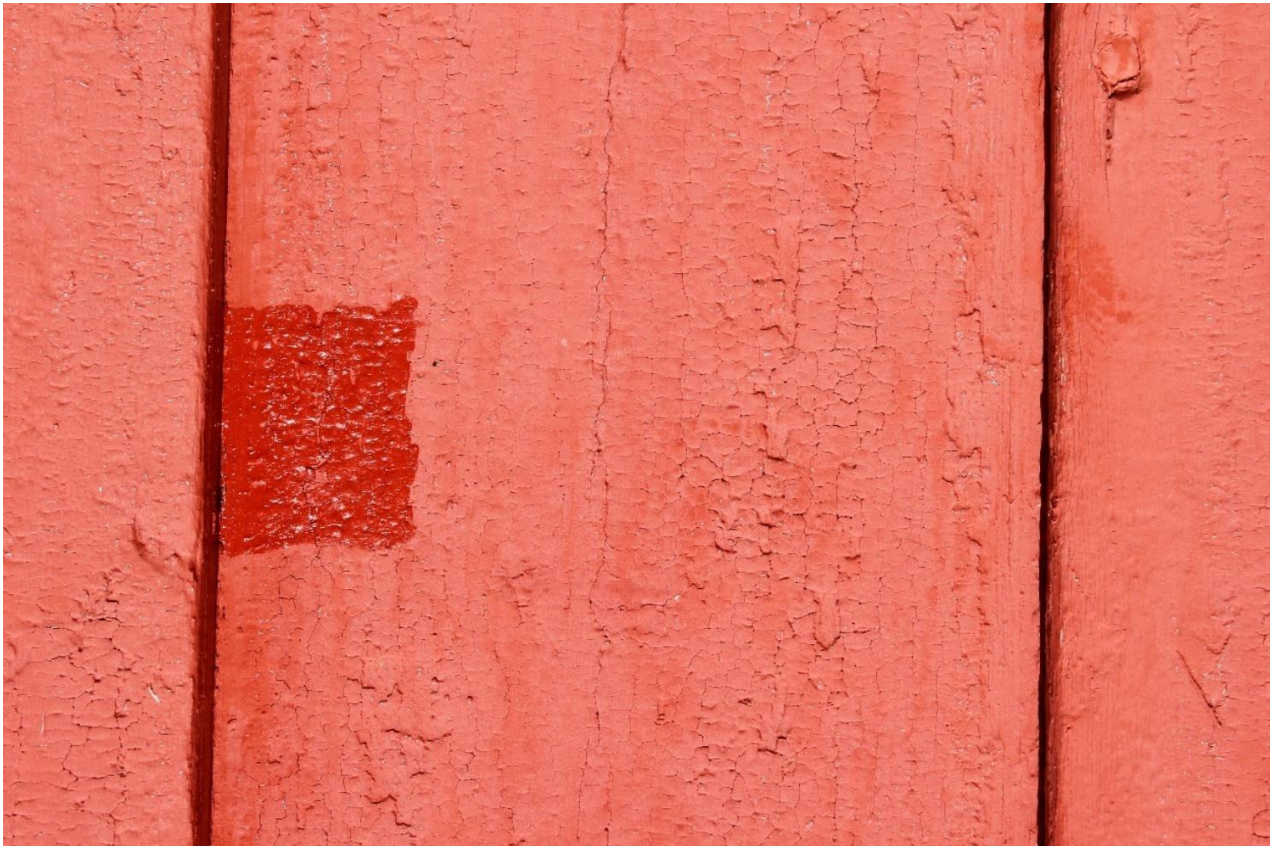
Figur 1. Lønset kirke. Bildet viser et område på sørveggen, hvor jeg har regenerert malingen. Ved å påføre en maleriferfenniss, mettes malingfilmens overflate med et svakt bindemiddel, som har tilsvarende egenskaper som det opprinnelige, nå nedbrutte bindemidlet. Den opprinnelige fargen, før nedbryting av bindemidlet i overflaten blir synlig, og kan bestemmes og kodes. Opprinnelig farge er rød jernoksid NCS S 4550-Y80R. Foto: J. Brønne. 22.8.2023.
