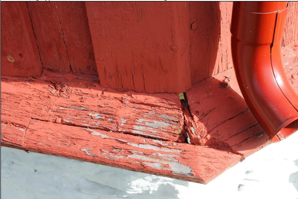
Figur 3. Lønset kirke. Detalj av sokkellista og nedre del av panelet. Bildet viser en eldre, ikke vellykket, innbøting på vassbordet. I dette tilfellet er det trolig nødvendig å bøte inn et stykke av hele vassbordet på begge sider av hjørnet, for å få en tett skjøt mellom vassbordene på hjørnet. De dyktige snekkerne som tidligere har utført arbeider på
