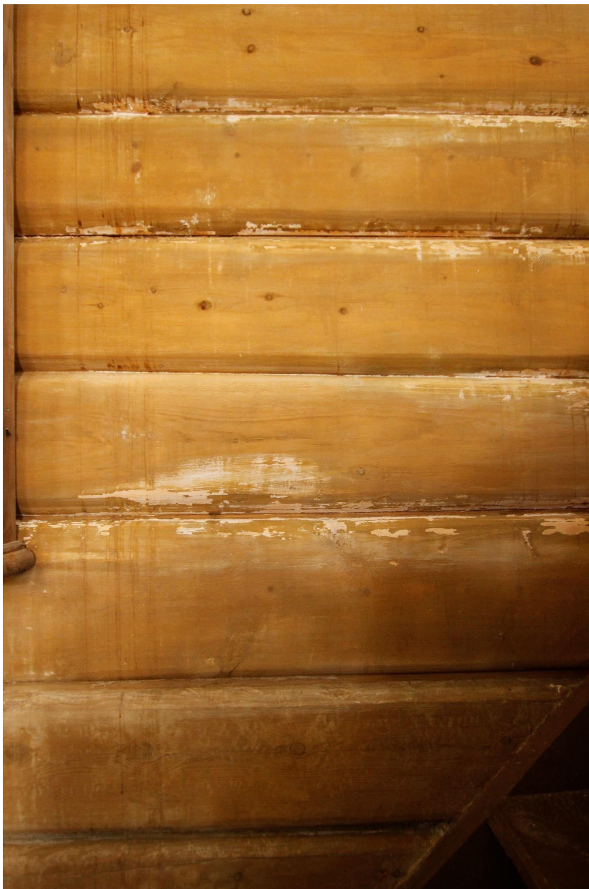
Figur 8. Lønset kirke. Detalj av en innbøtet, nyere tømmervegg. Vi ser den nye tynnelasuren som er strøket på tømmeret, spor etter lut som har rent på veggen, og lasuren som har løst seg på grunn av aktivisering av lutrester i tømmeret. Foto: J. Brønne. 22.8.2023.
