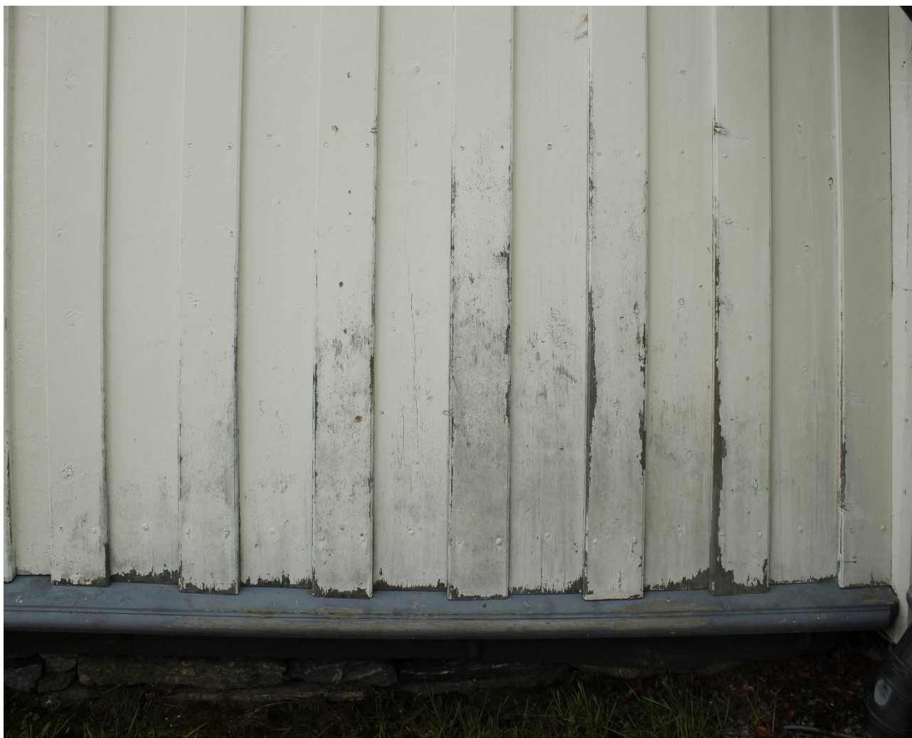
Figur 6. Oppdal kirke. Detalj av nordveggen, som viser svertesoppangrep og avskallinger på panelet ned mot vassbordet og på kantene av overliggerne på panelet. Skadene kan relateres til snø og høy fuktighet gjennom deler av året. Foto: J. Brønne. 22.8.2023.
