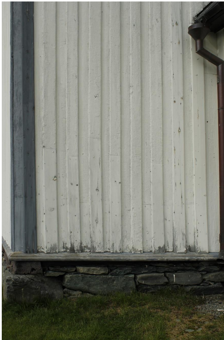
Figur 1. Oppdal kirke. Detalj av østveggen. Malingen på vassbordet er helt avslitt. Det er fuktskader med opp-, og avskallinger i nedre del av panelbordene. Noen av panelbordene har også gjennomslag av kvister. Foto: J. Brønne. 22.8.2023.
