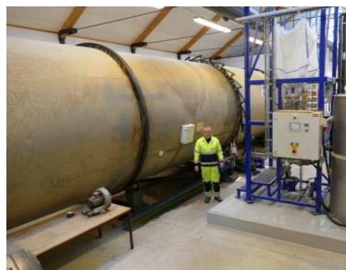
Figur 22 Tilknytning til kommunalt avløp gir god kvalitetskontroll. Bilde fra Oppdal sentrum renseanlegg.
